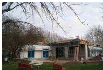
Die Sanierung schreitet voran und soll in 2014 abgeschlossen sein. (Foto: MODUL Projektmanagement GmbH)
