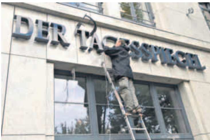
DIE LETTERN MÜSSEN MIT. Am neuen Gebäude wird der Schriftzug des Tagesspiegels angebracht. Ein wenig dezenter als an der Potsdamer Straße, aber nicht minder prominent. Ob sich für die großen alten Buchstaben wohl ein Liebhaber findet? Foto: Mike Wolff
